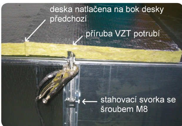
Obr. 26 Spojе izolačních desek leží mimo příruby VZT potrubí
